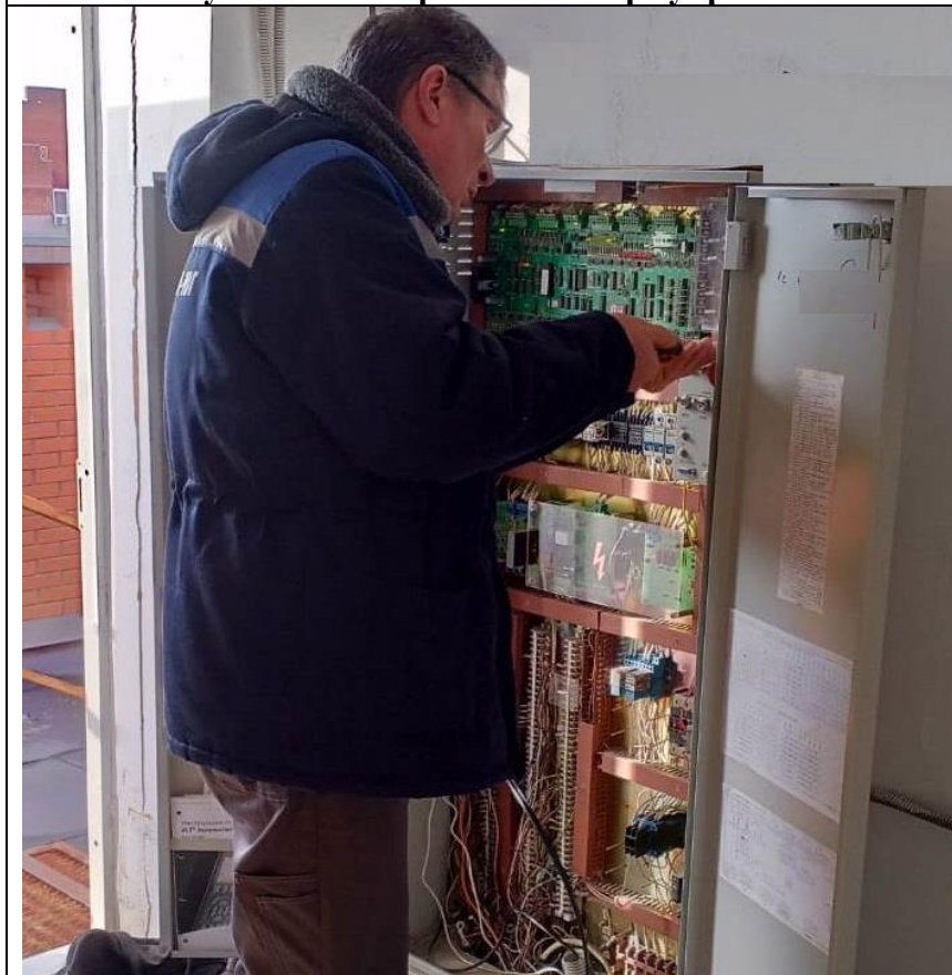
Обслуживание лифтового шкафа управления.
