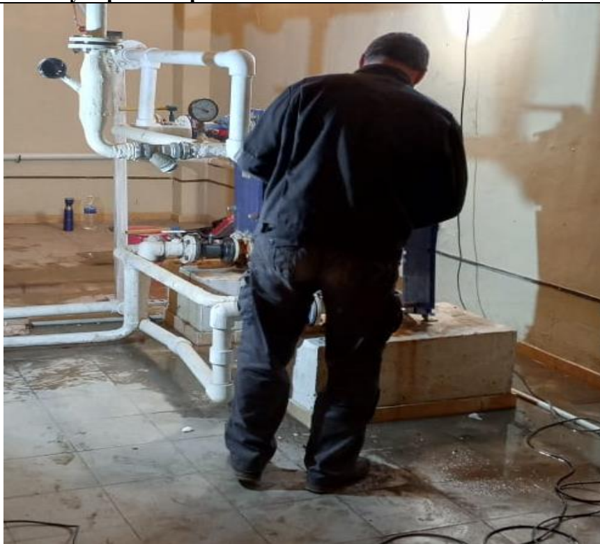
Регулировка в работе автоматики насосной станции.
