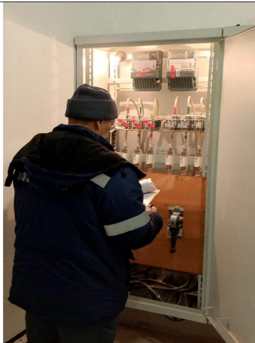
Ревизия электро щитового оборудования.
