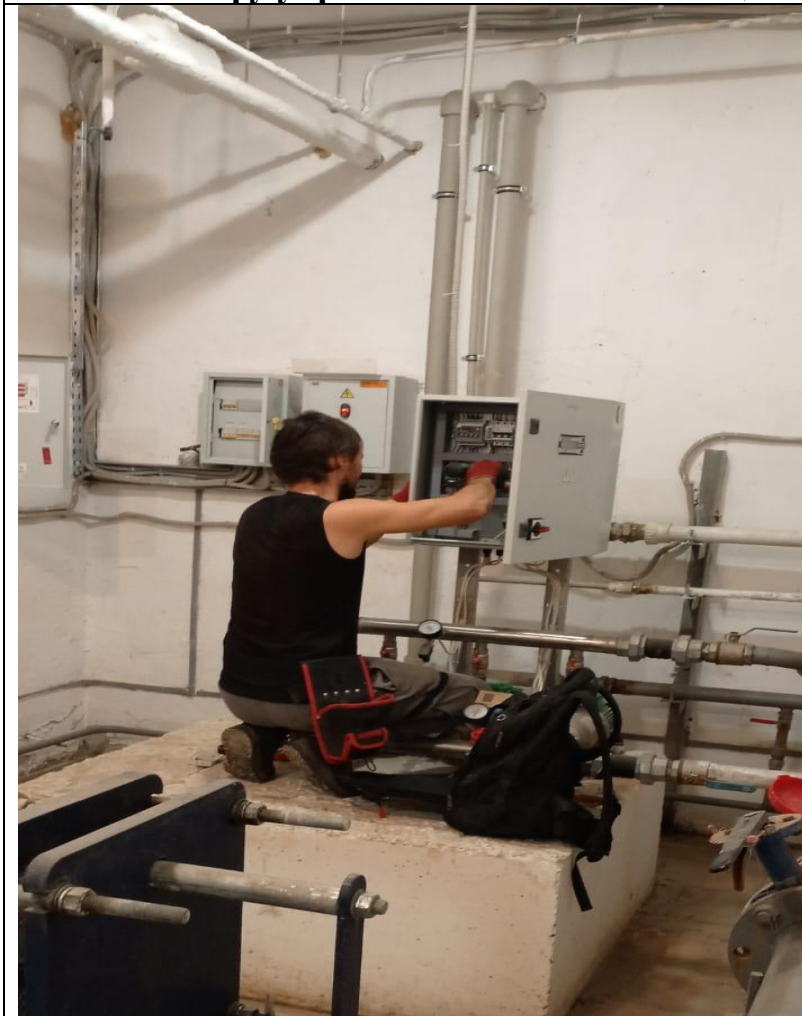
ТО в шкафу управления насосной станции
