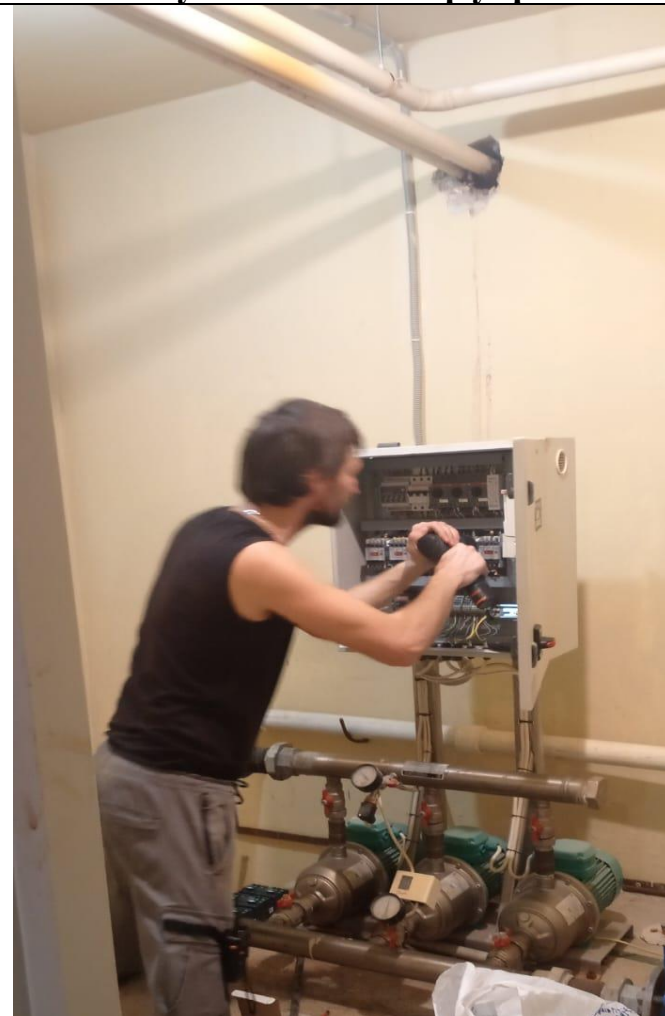
Тех обслуживание- шкаф управления
