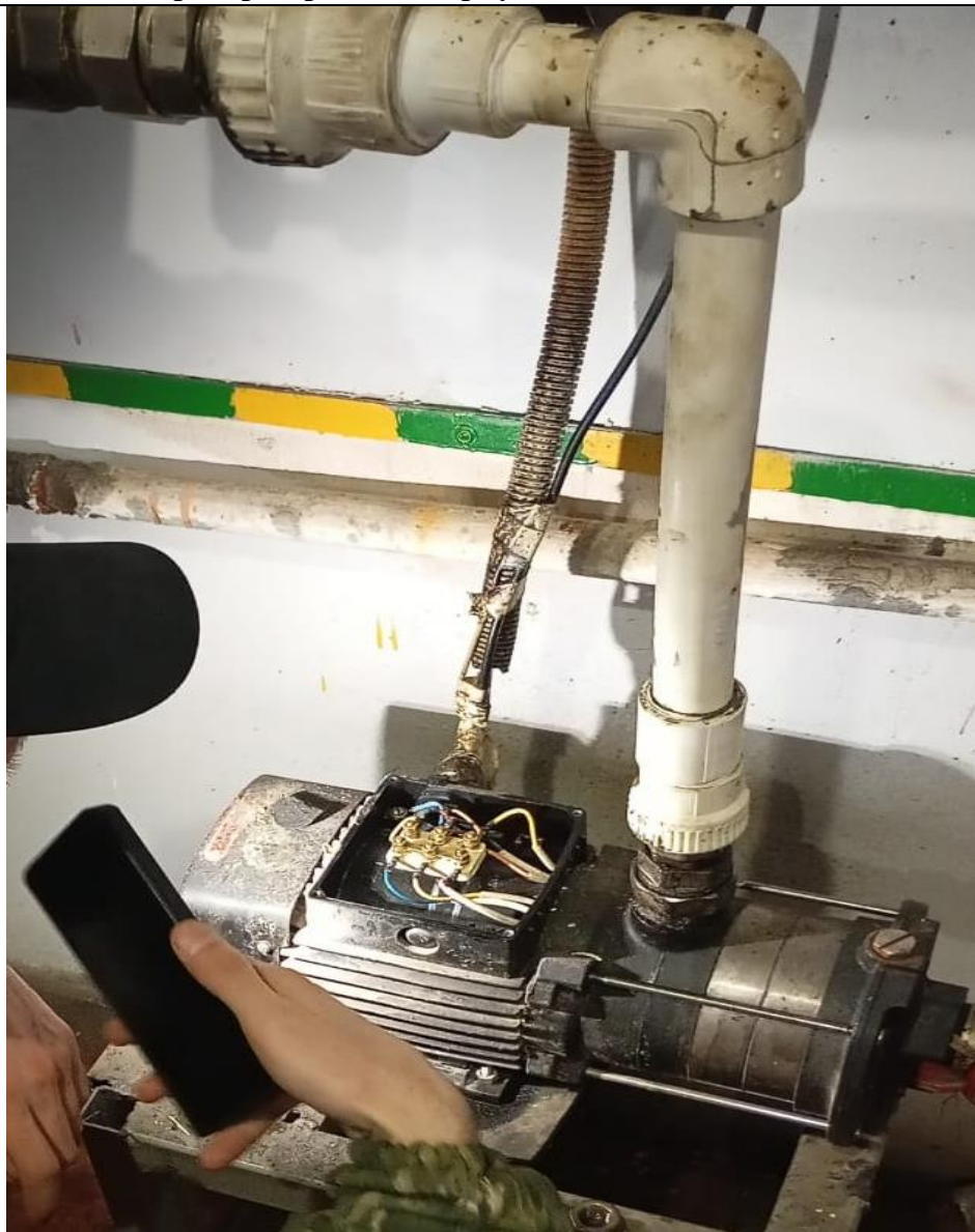
Проверка работы циркуляционного насоса.
