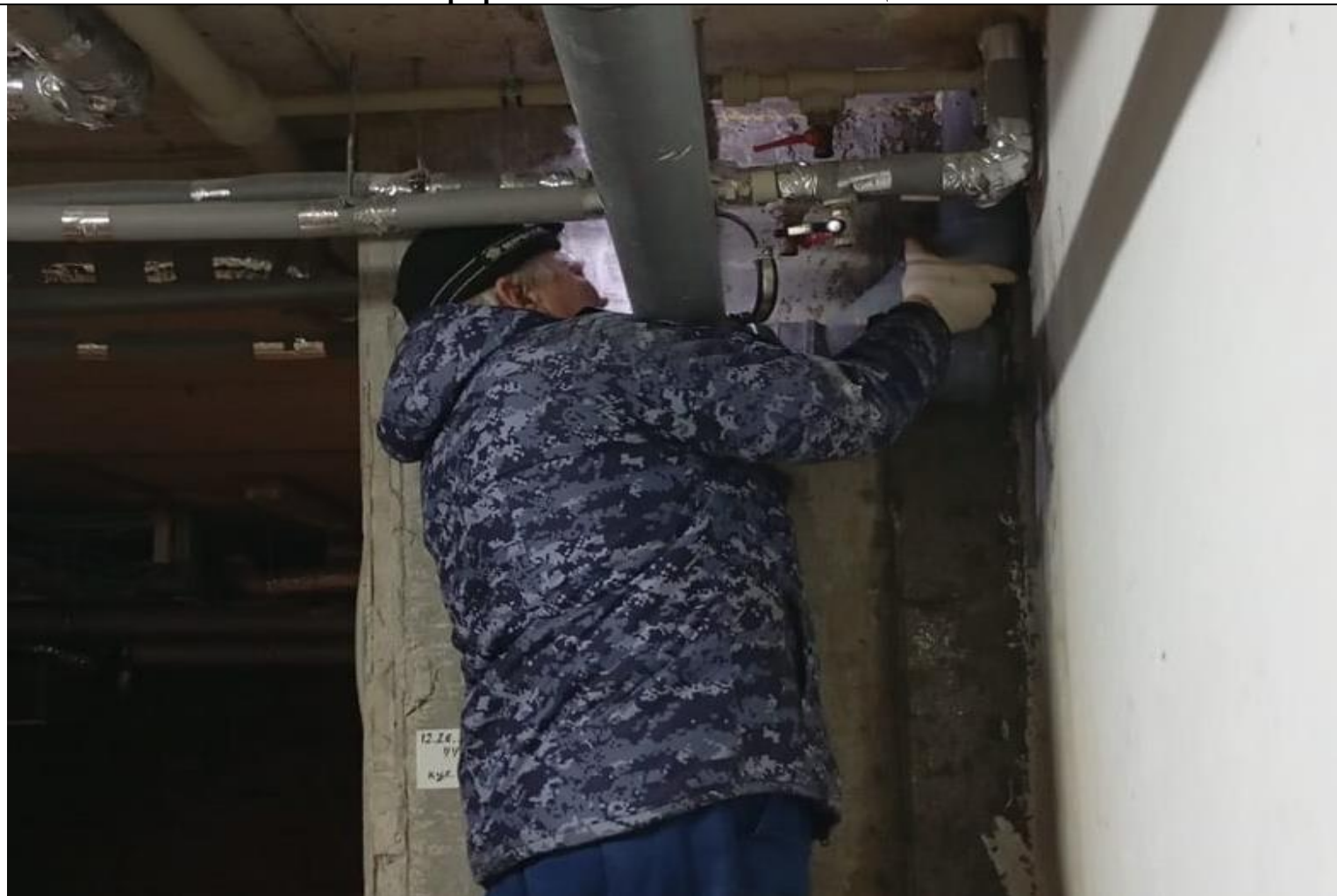
Профилактика системы канализации.
