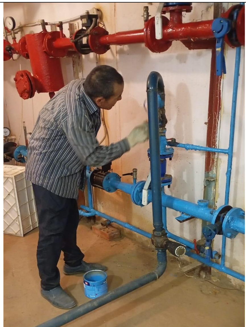
Обслуживание тепловых рамок
