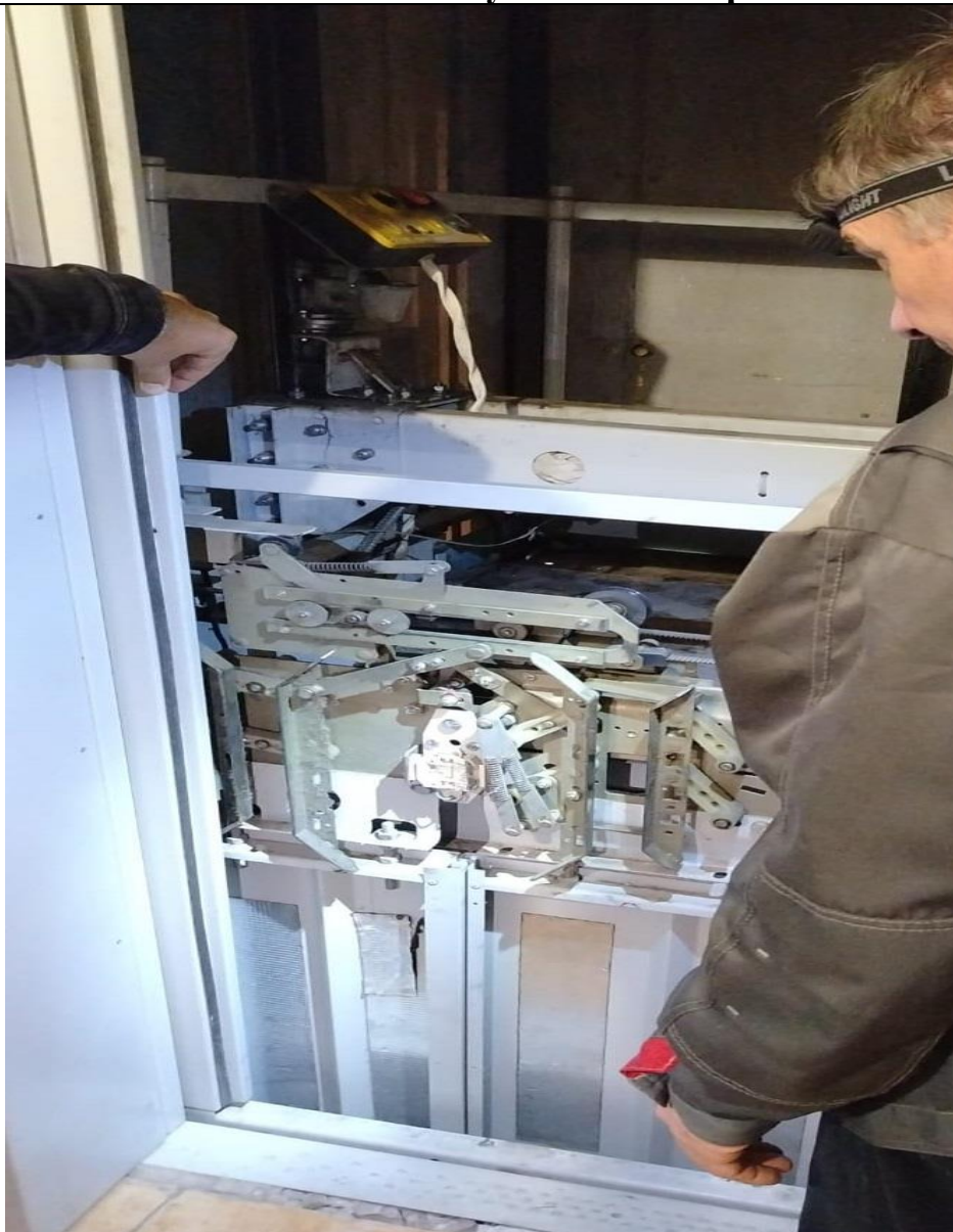
Регламентное обслуживание лифтов
