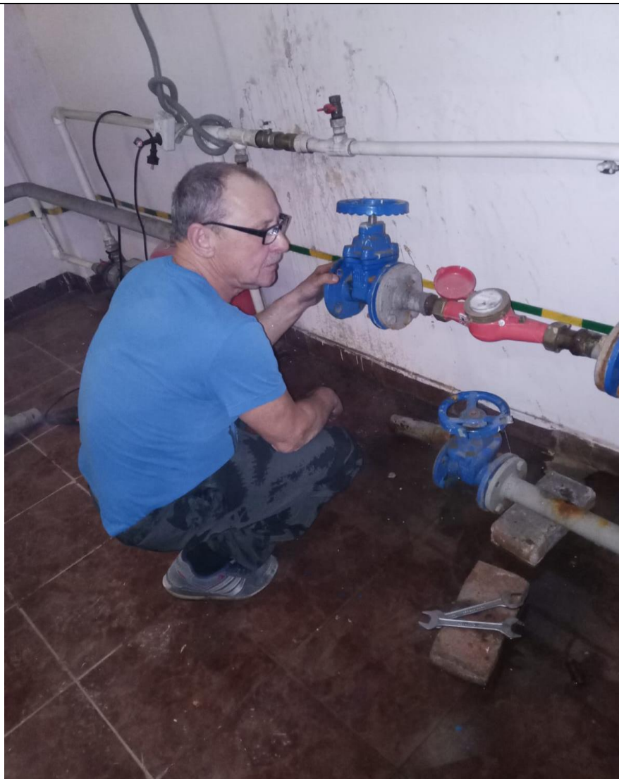
Проведение технического обслуживания
