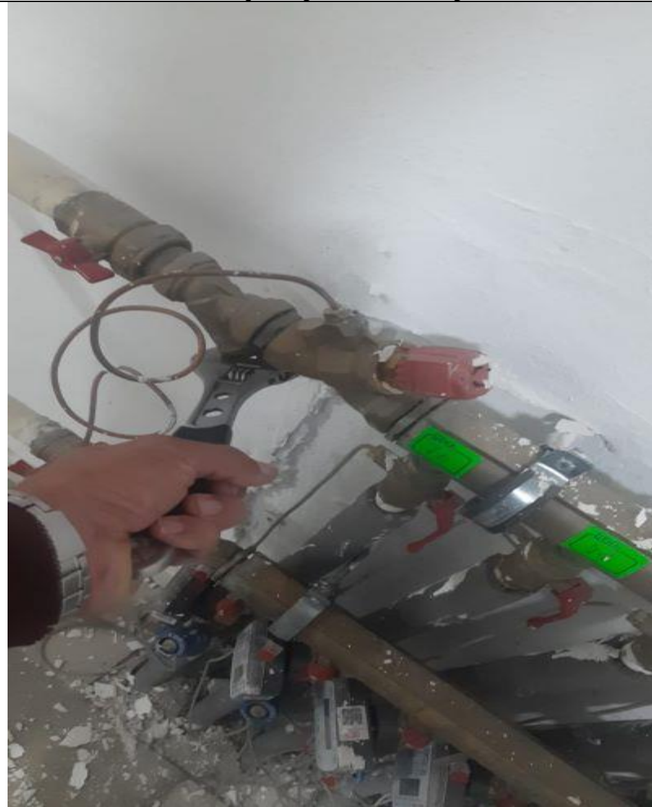
Чистка фильтров в коллекторной
