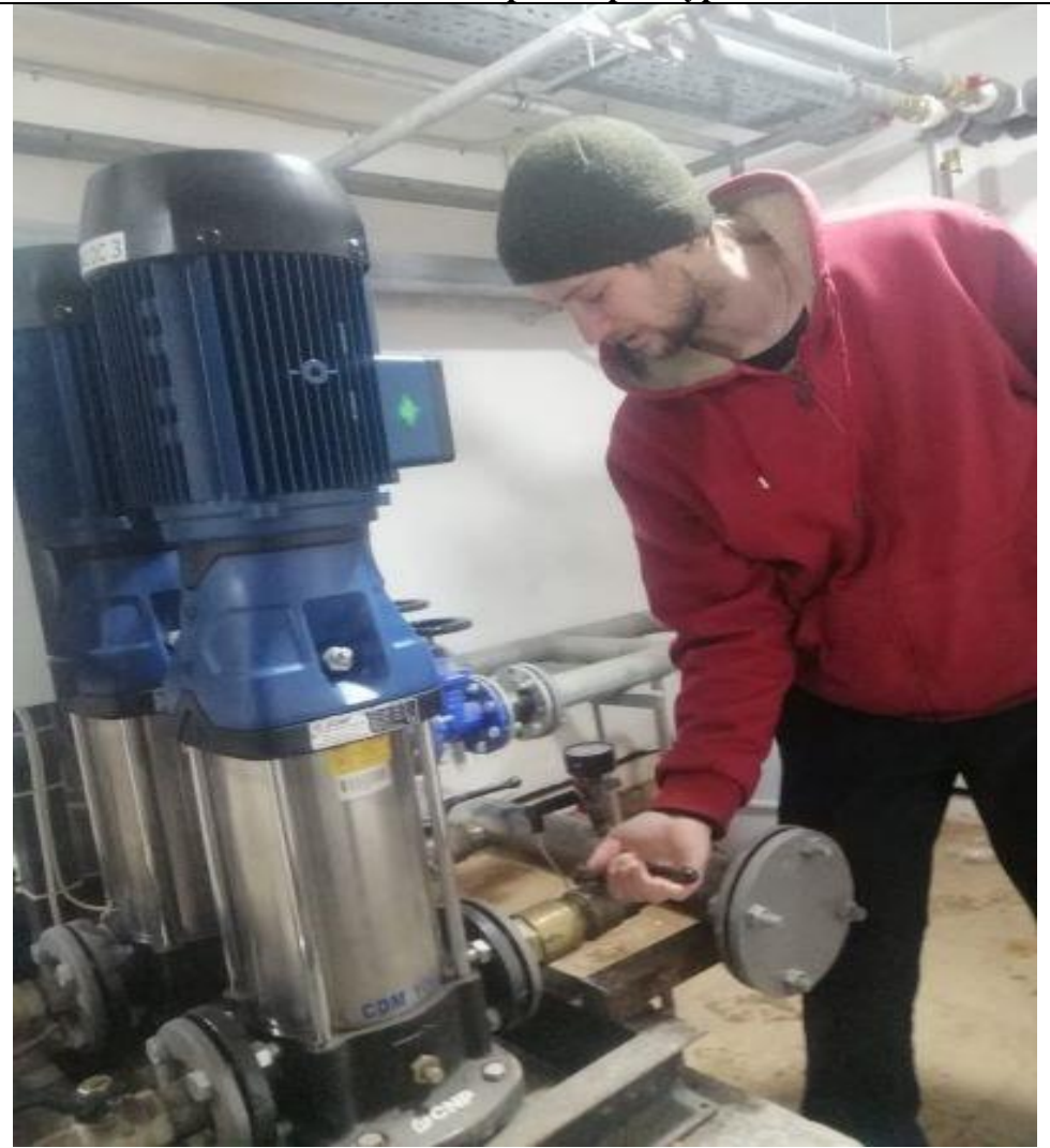
Ревизия запорной арматуры
