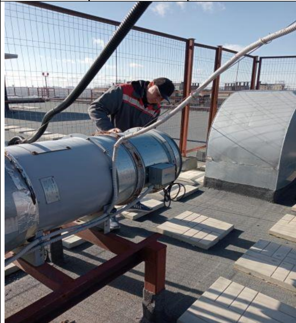
Проверка работоспособности всех приводов автоматического открытия клапанов дымоудаления
