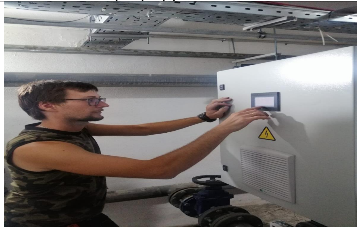
Осмотр настроек управления насосами ХВС
