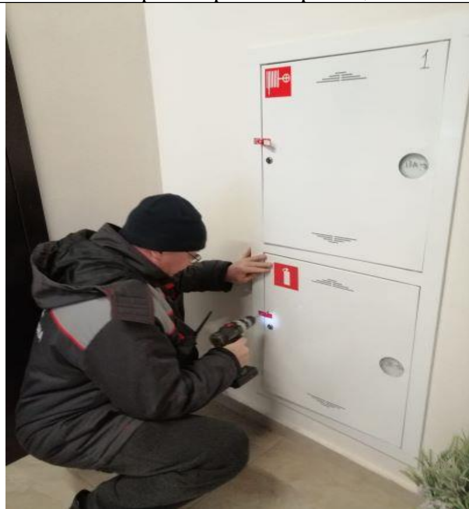
Опломбирование противопожарных ящиков
