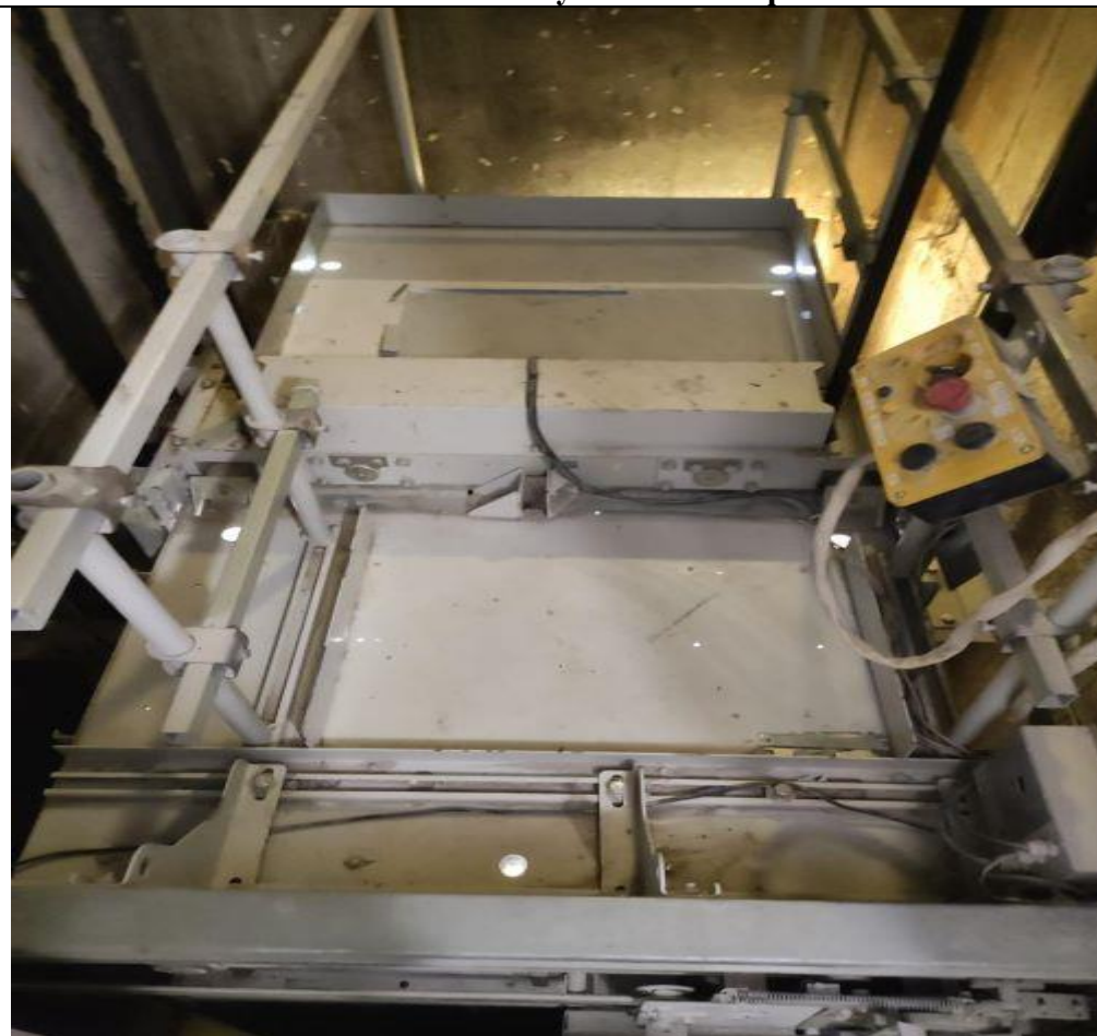
Техническое обслуживание лифтов
