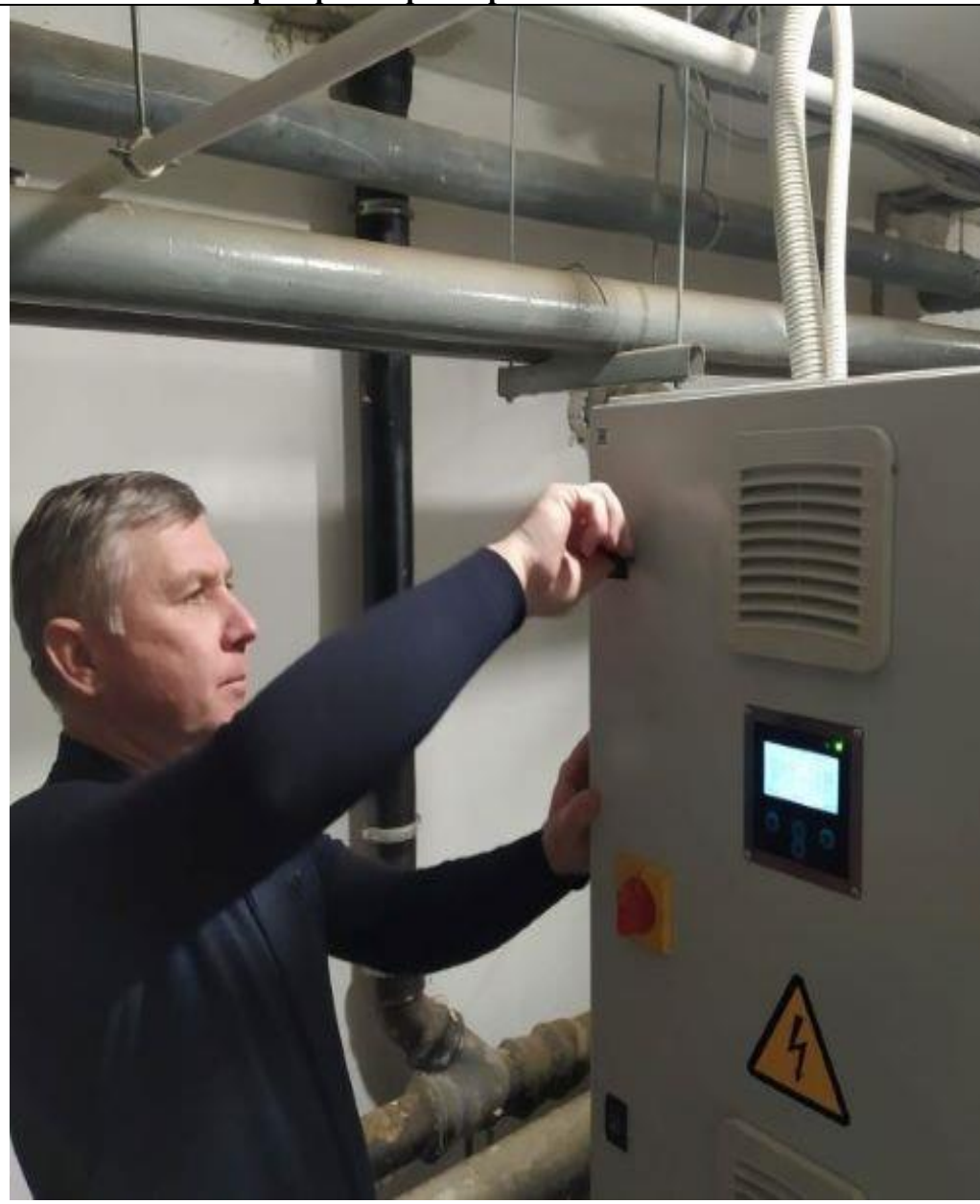
Проверка параметров в насосной ХВС
