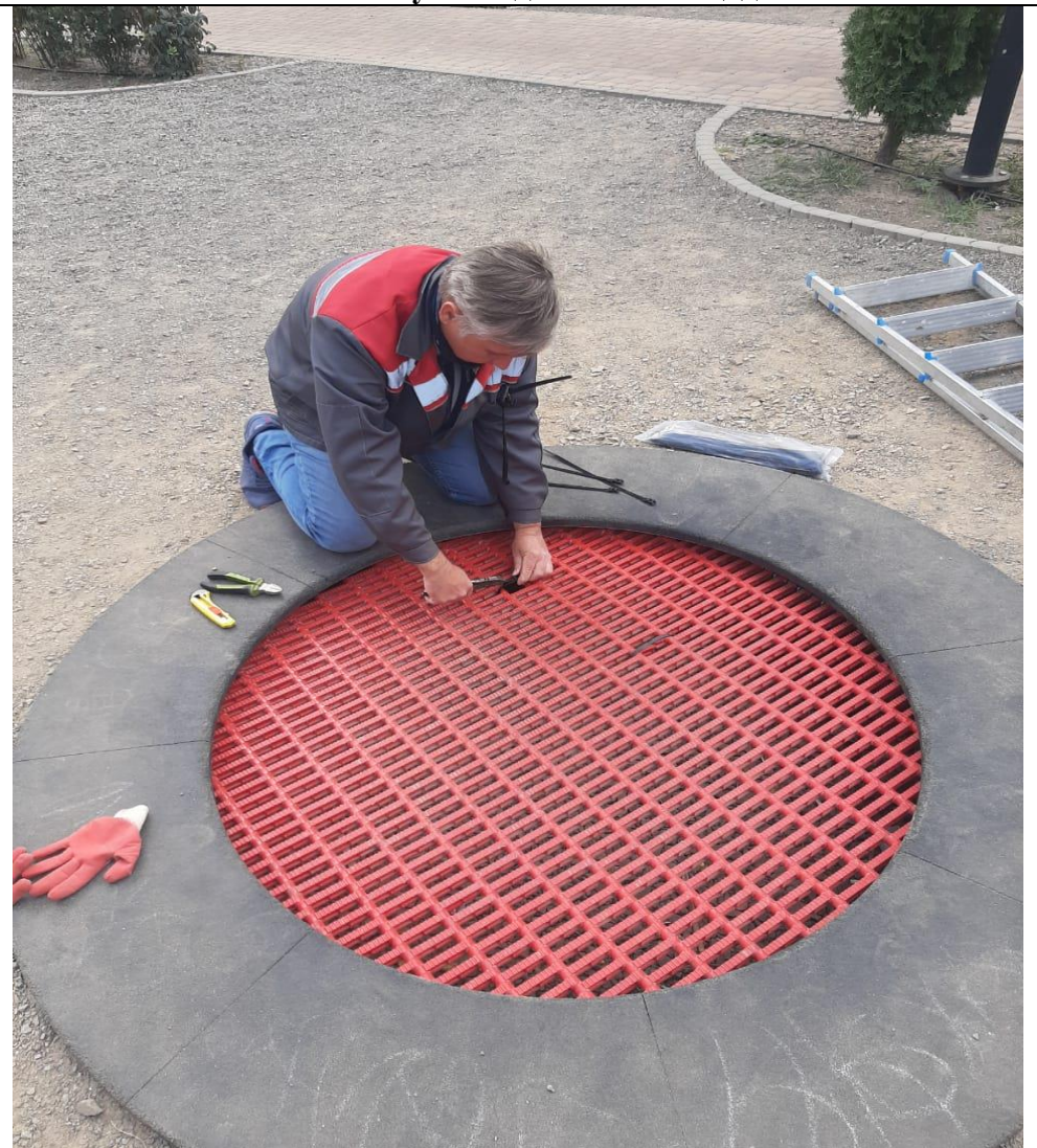
Ремонт батута на детской площадке
