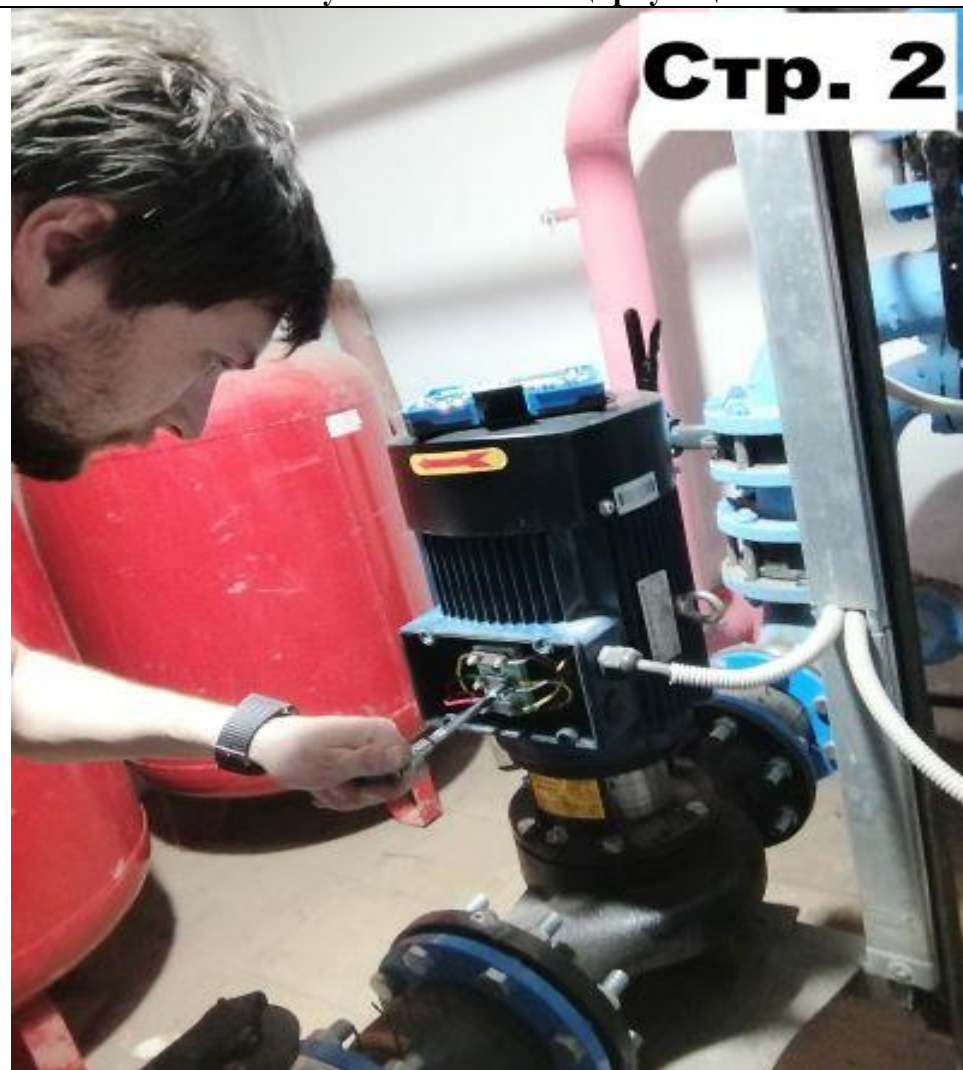
Техническое обслуживание насоса циркуляции отопления
