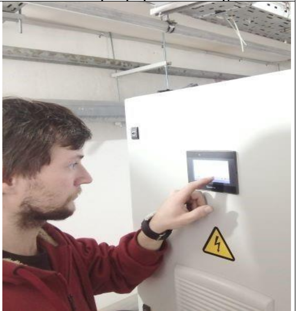
Установка параметров работы насосной группы
