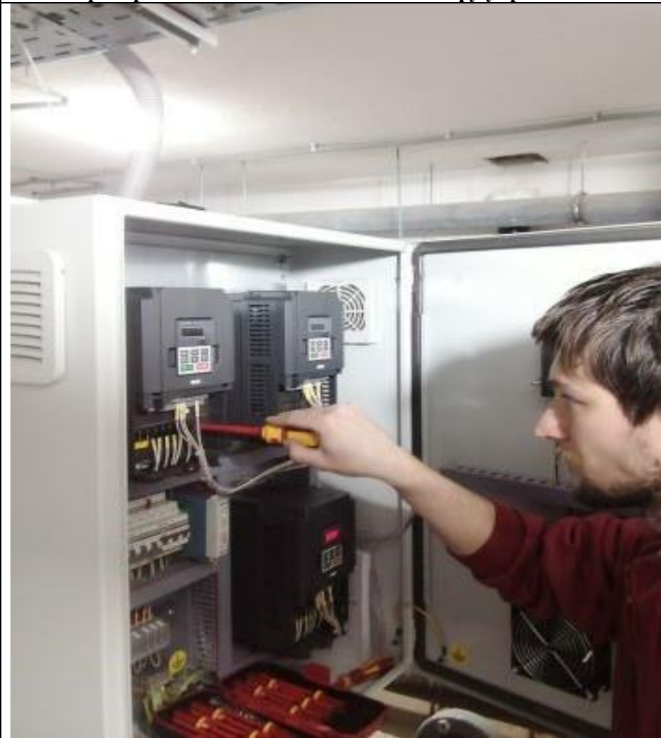
Проверка клемных соединений в шкафу управления
