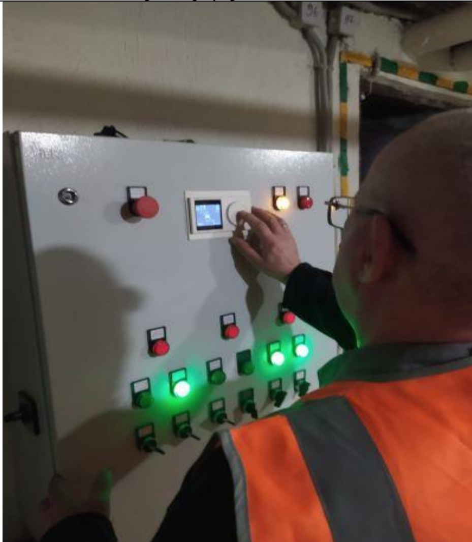
Осмотр шкафа управления отопления
