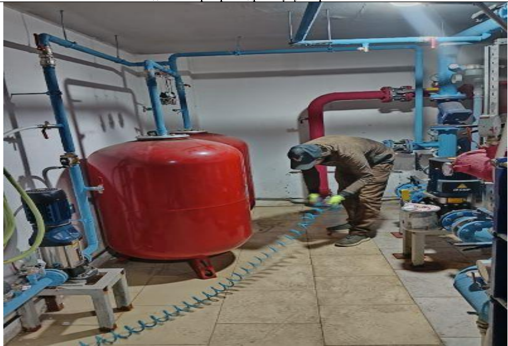
Подкачка и проверка гидро-аккумуляторных баков
