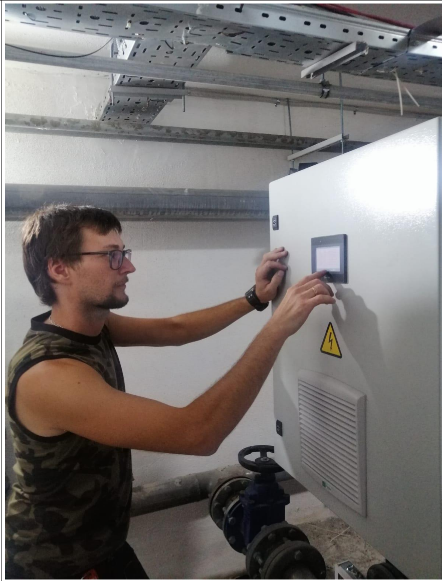
Настройка управления насосами ХВС
