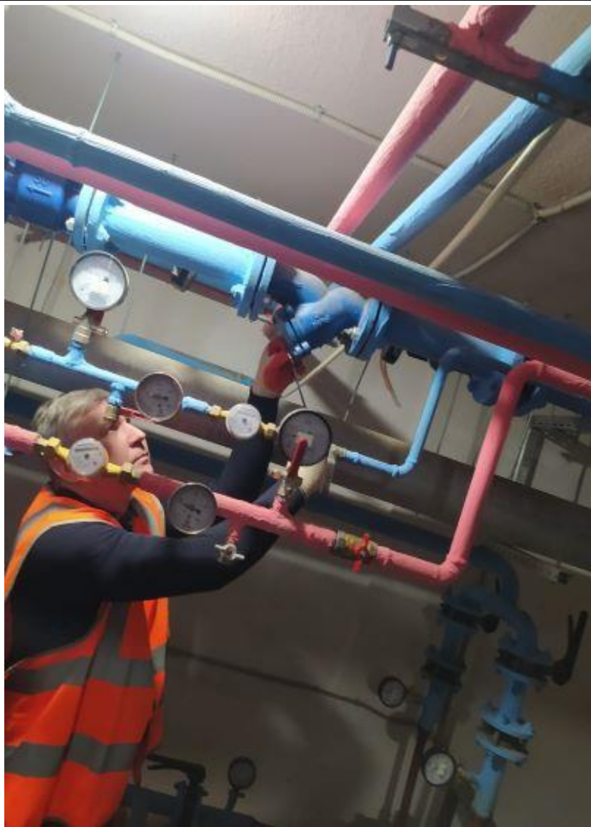
Очистка фильтра в ТП
