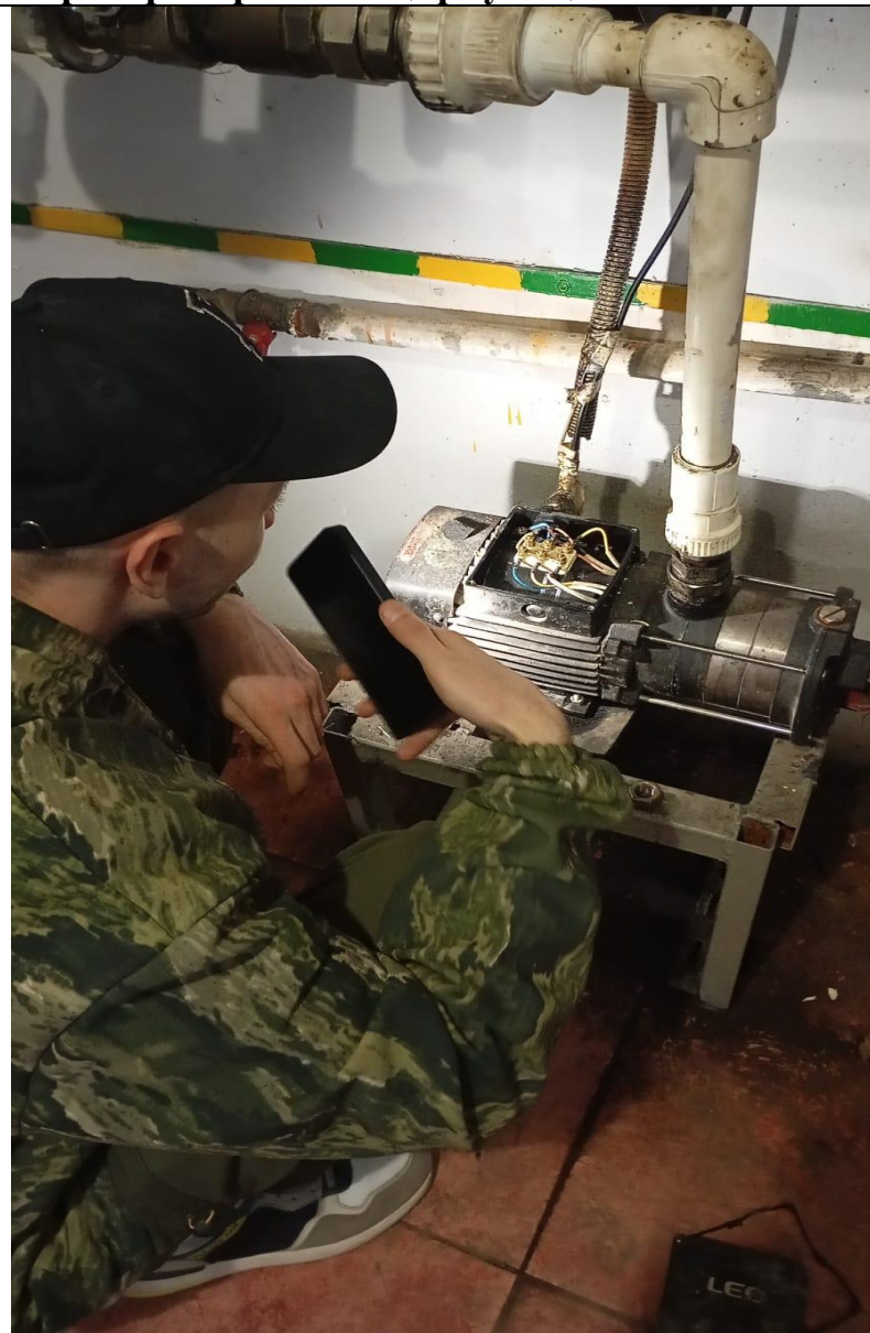
Проверка работы циркуляционного насоса
