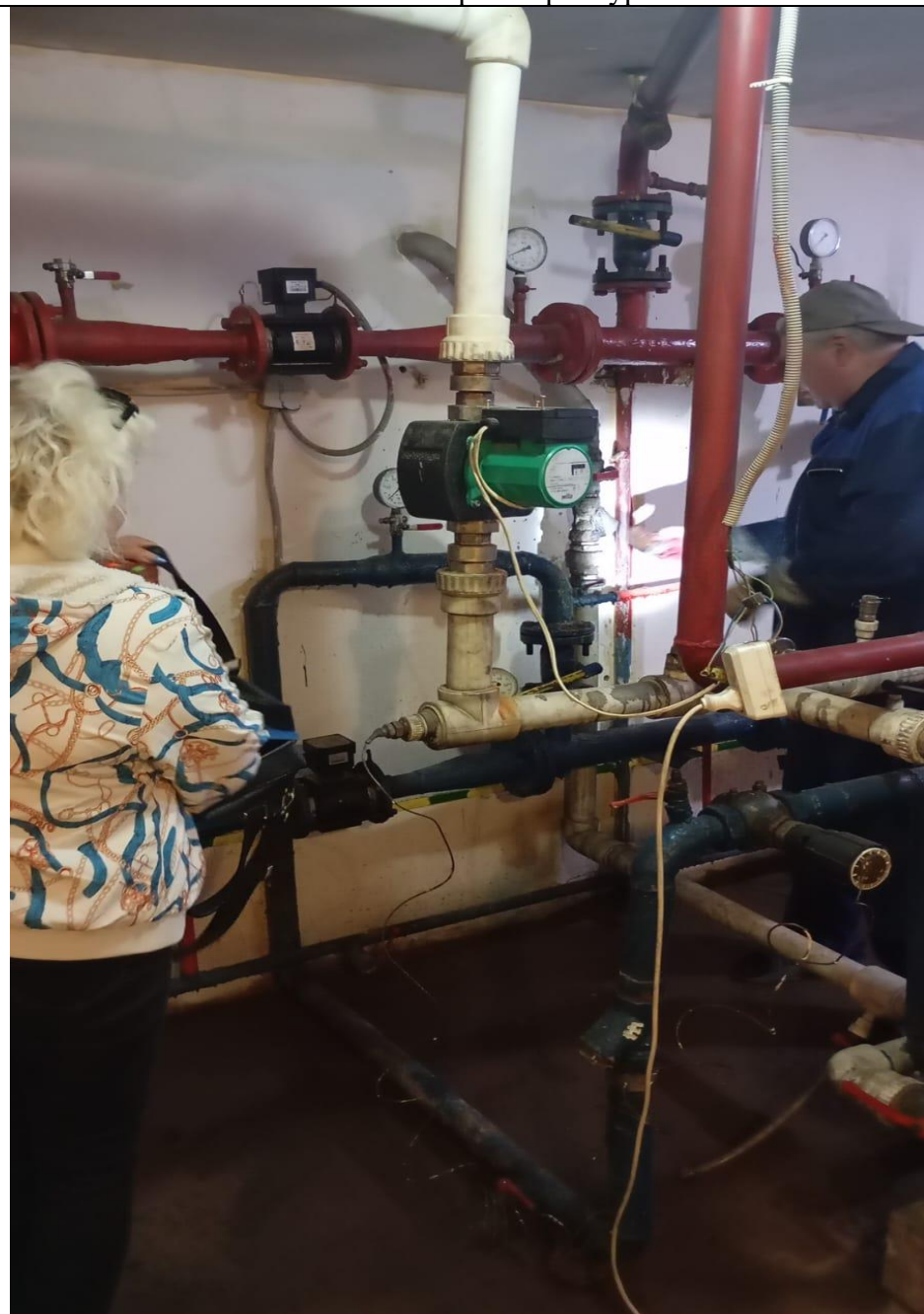
Ревизия запорной арматуры
