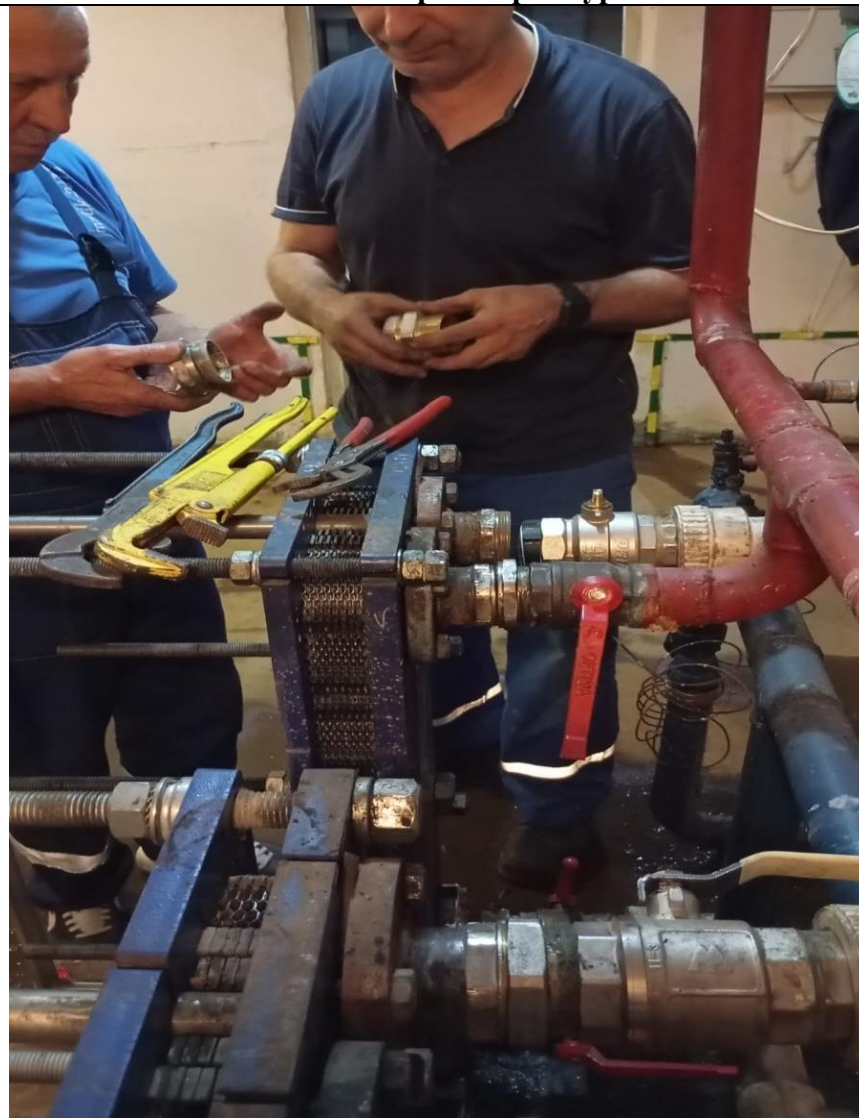
Ревизия запорной арматуры.
