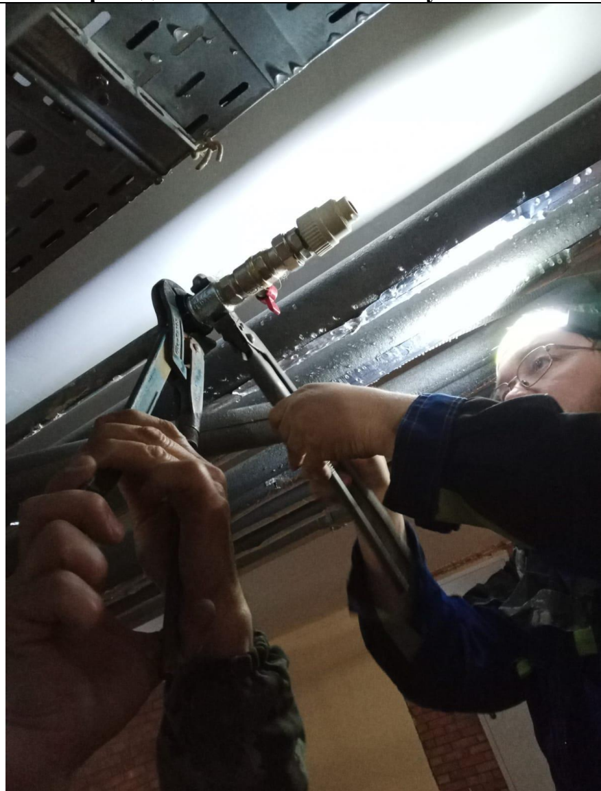
Проведение технического обслуживания
