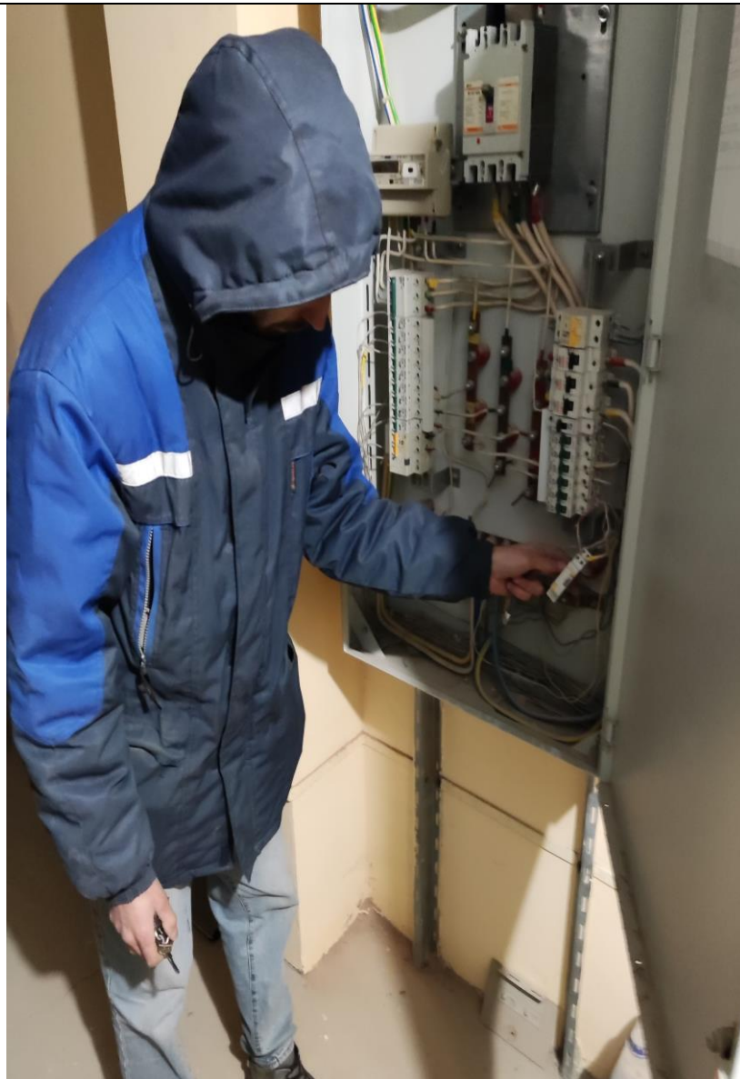
Ревизия электро-щитового оборудования.
